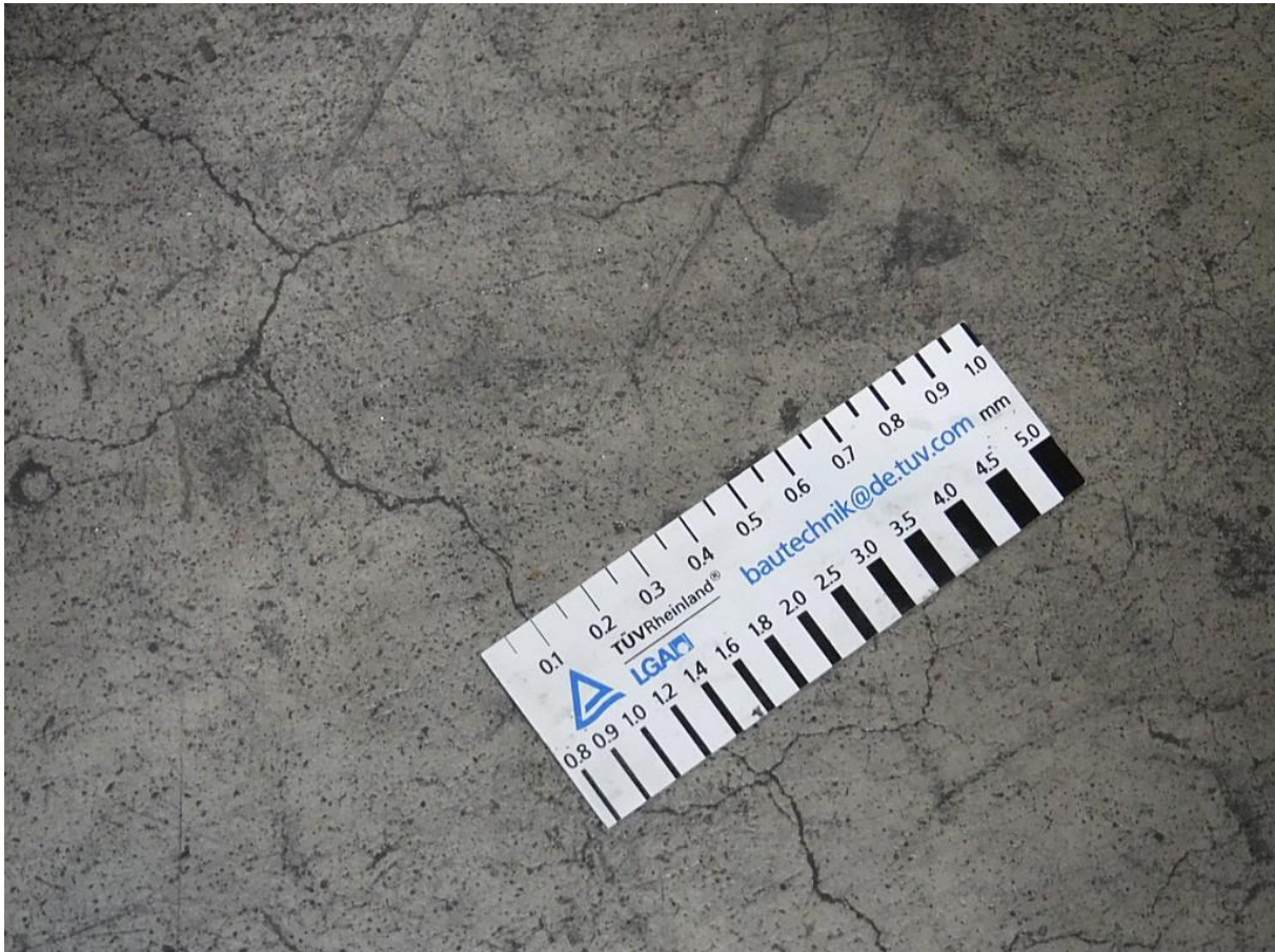
Abbildung 3 – Rissbreitenmessung mit Risslineal
