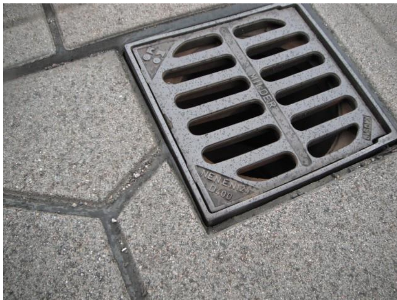
Abbildung 1 – Schadhafte Fuge am Straßenablauf
