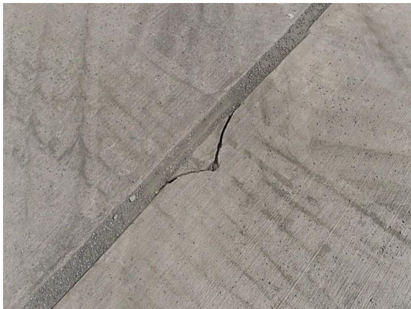
Abbildung 5 – Kantenabplatzung im Fugenbereich
